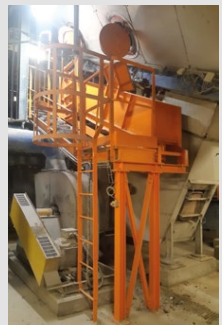
Nouveaux équipements permettant de limiter le risque d'accident lié à la répétition des arrêts.
